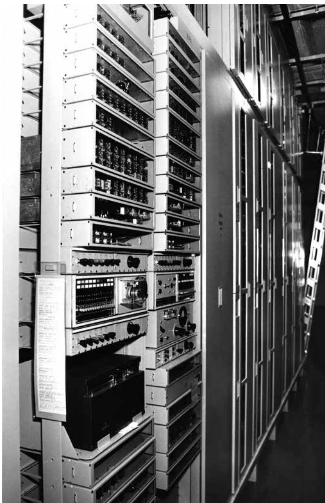
Instalaciones de la Central Telefónica.
